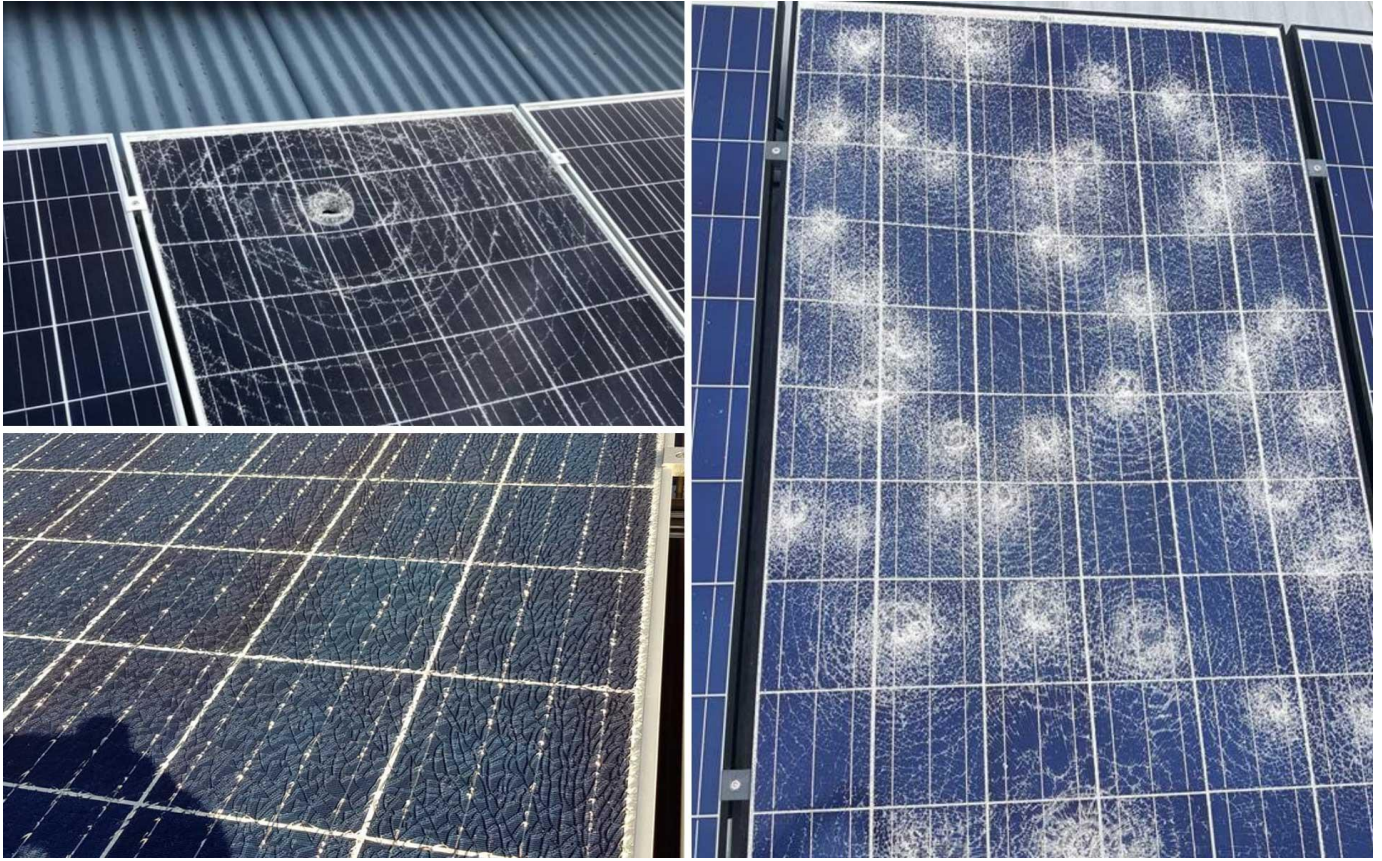
Hình 4. Các tấm pin bị hư hỏng, nứt vỡ
